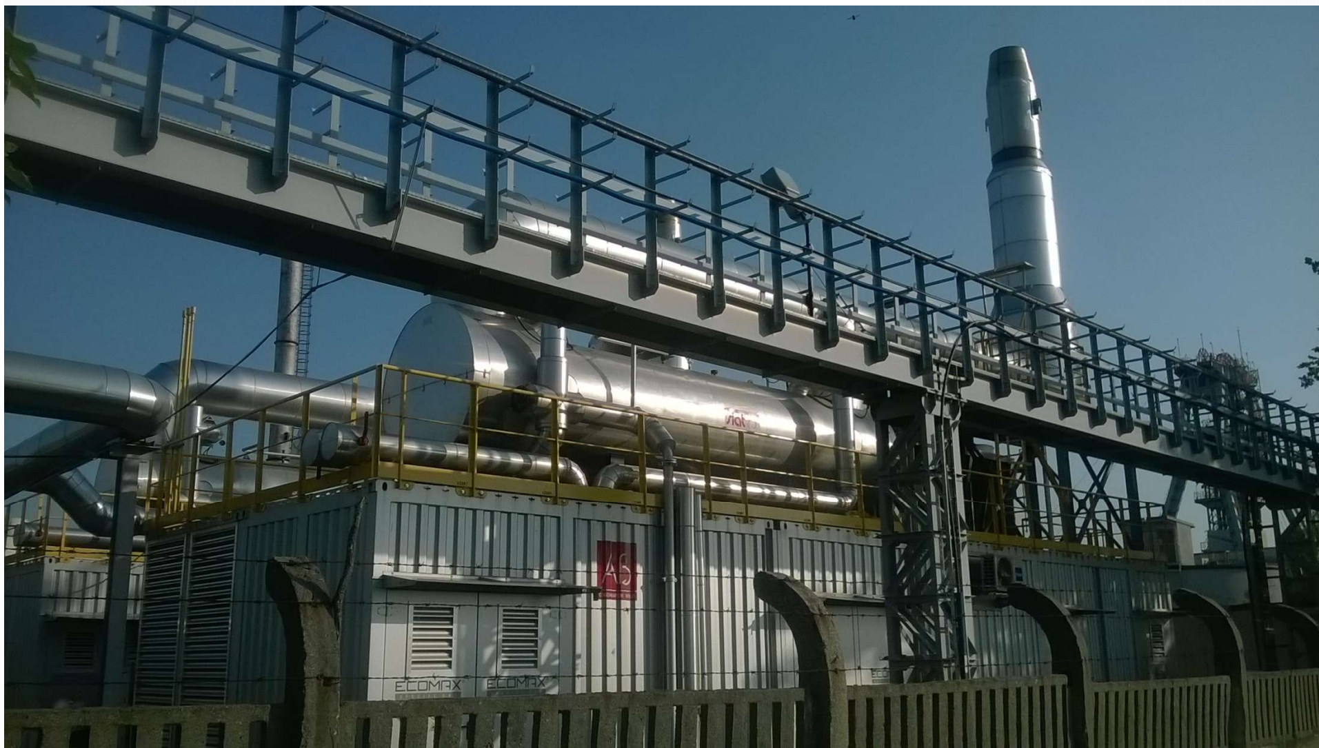
Instalacja metanowa na KWK Budryk (2x 4MW). Podłączenie do stacji odmetanowania gminnej instalacji metanowej (0,5MW + 1,5MW)
