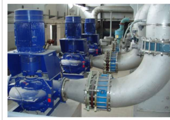
Przepompownia – nadzorowana zdalnie
